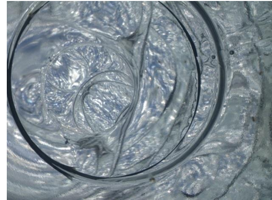
【ダクト内写真】
